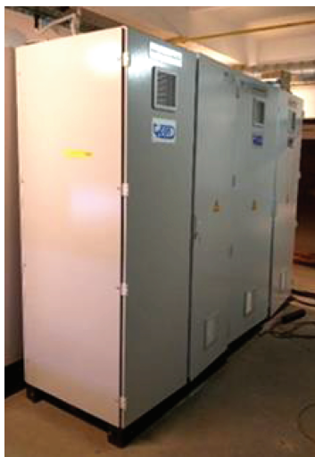
Фото 2. Блоки системы автоматического управления «ТЕКОН»
