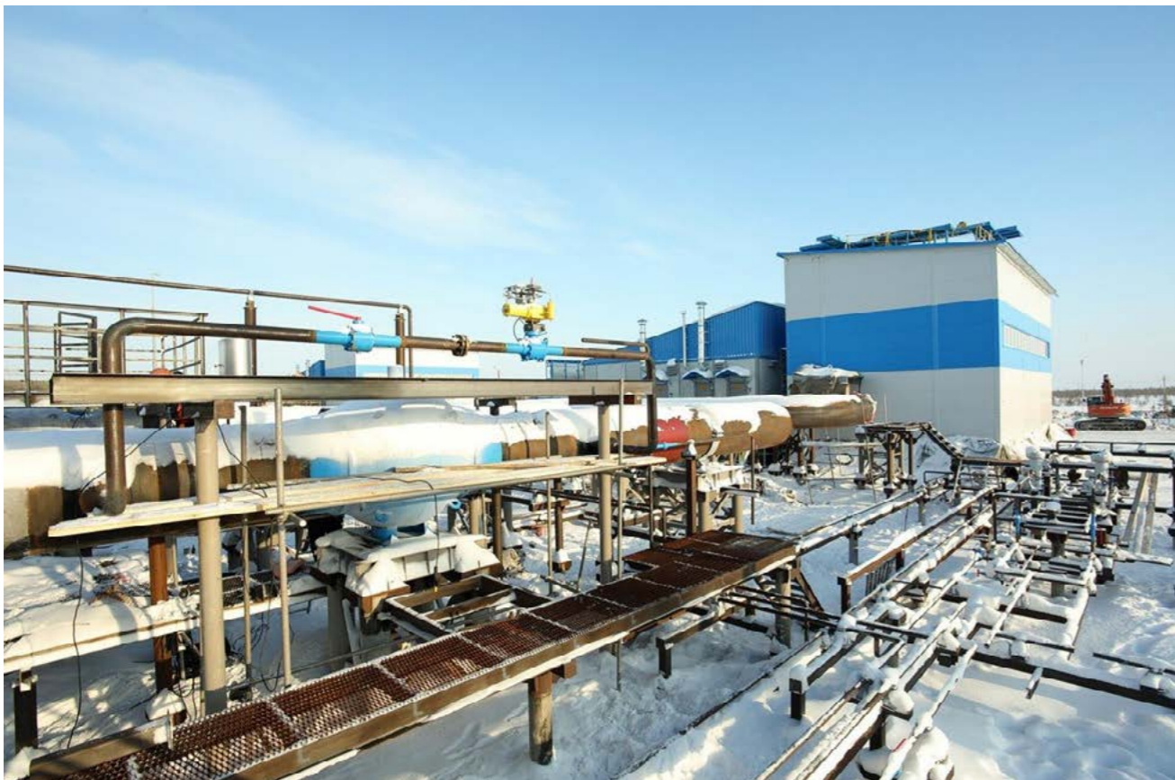
ЭГПА 10,0 МВт на Еты-Пуровском ГКМ
