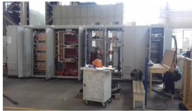
Заводские испытания ПЧТ 6-10000-6-Ж-01
