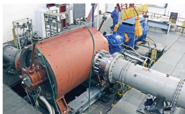
Испытательный стенд центробежных компрессоров
