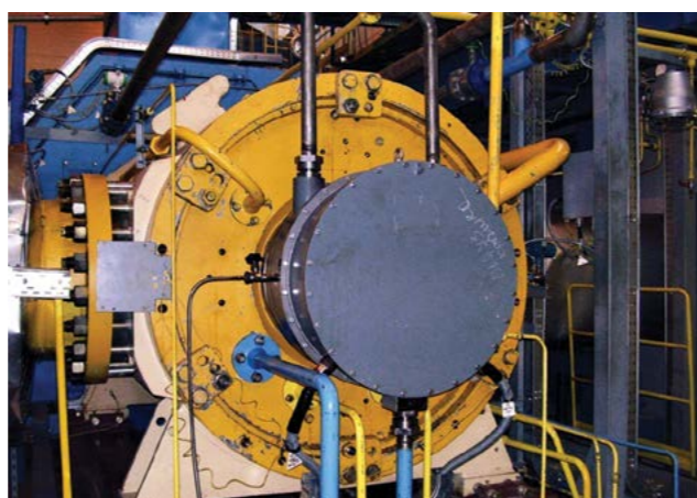
СПЧ производства РЭП Холдинга с применением системы активного магнитного подвеса на ДКС Западно-Таркосалинского газового промысла
