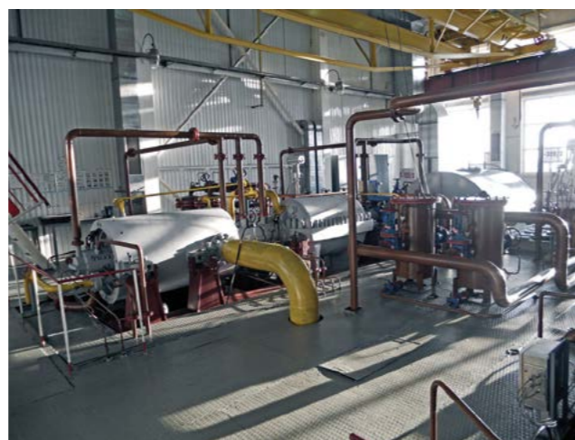
Центробежный компрессор K320-131-1 на КС Северо-Даниловского месторождения ТПП
