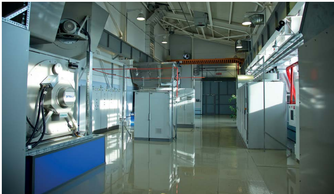
ЭГПА 4,0 МВт на КС «Володино» магистрального газопровода «Парабель-Кузбасс»
