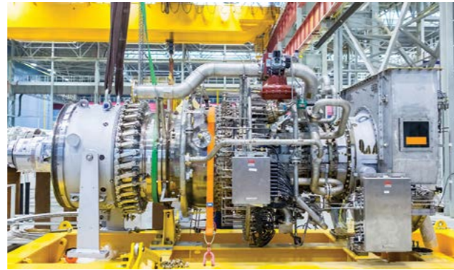
Газотурбинная установка Т16
