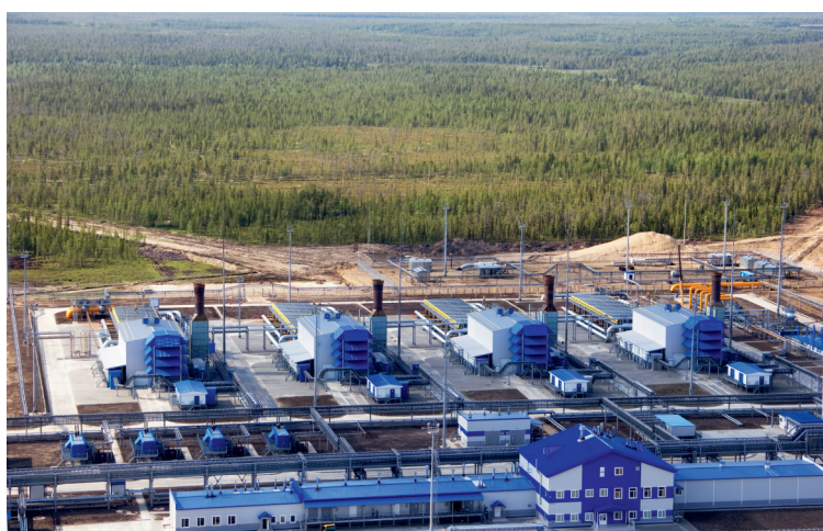
ГПА-32 Ладога на КС-8 «Чикшинская» МГ «Бованенково-Ухта»
