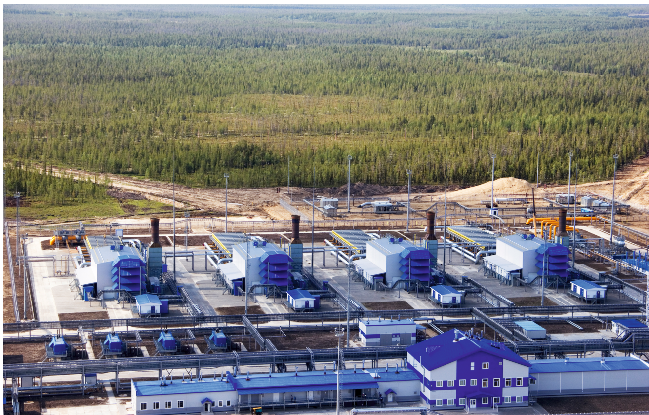
ГПА-32 Ладога на КС-8 «Чикшинская» МГ «Бованенково-Ухта»
