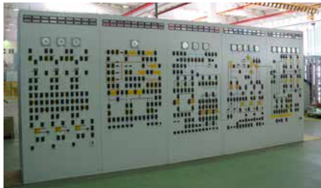
The special control panels (ПС-5, ПС-6, ПС-7, ПС-8)
